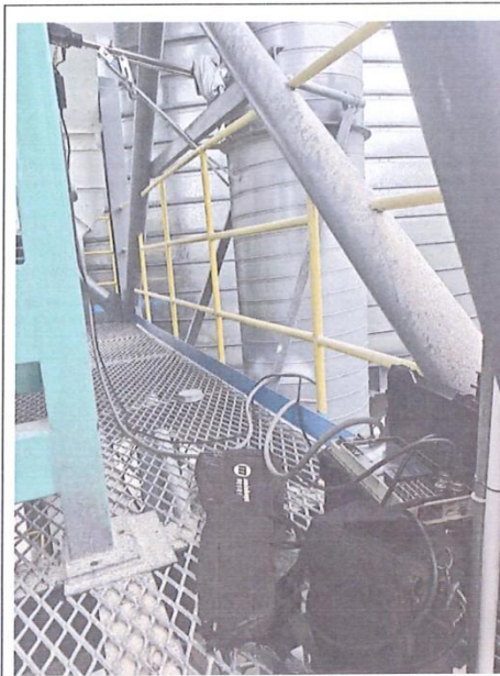
投料工序废气排放口 DA012
