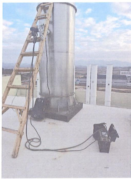
混合、制粒冷却系统粉尘废气排放口 DA008
