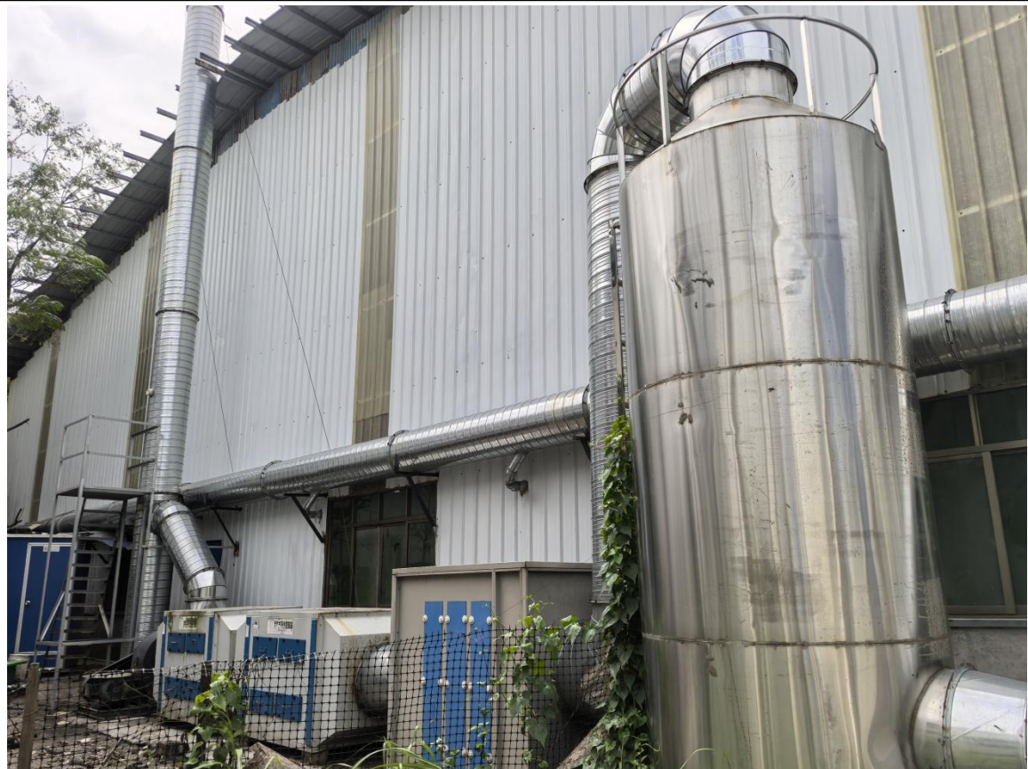
废气处理设施
