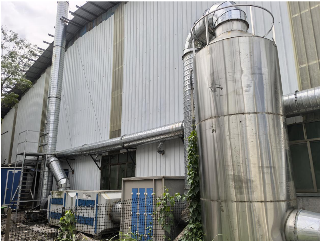
废气处理设施
