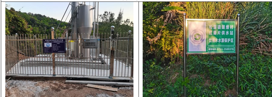
湖维村供水站
