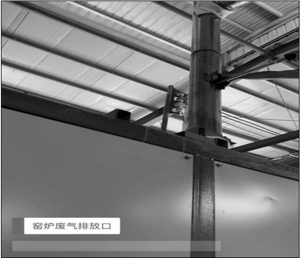
炉窑废气排气筒
