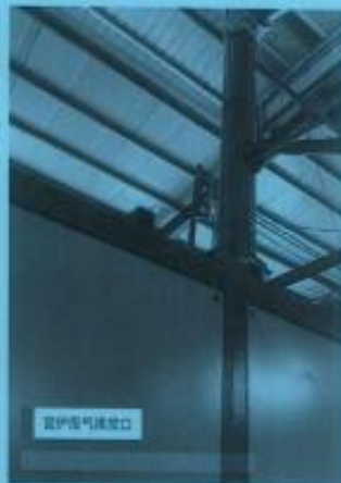
炉窑烧制废气排放口 (DA001)
