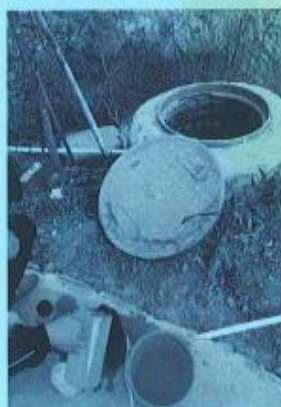
生活污水处理后排放口
