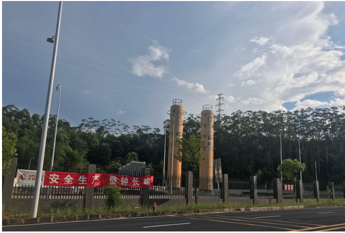
气化站（含 2 个储气罐）
